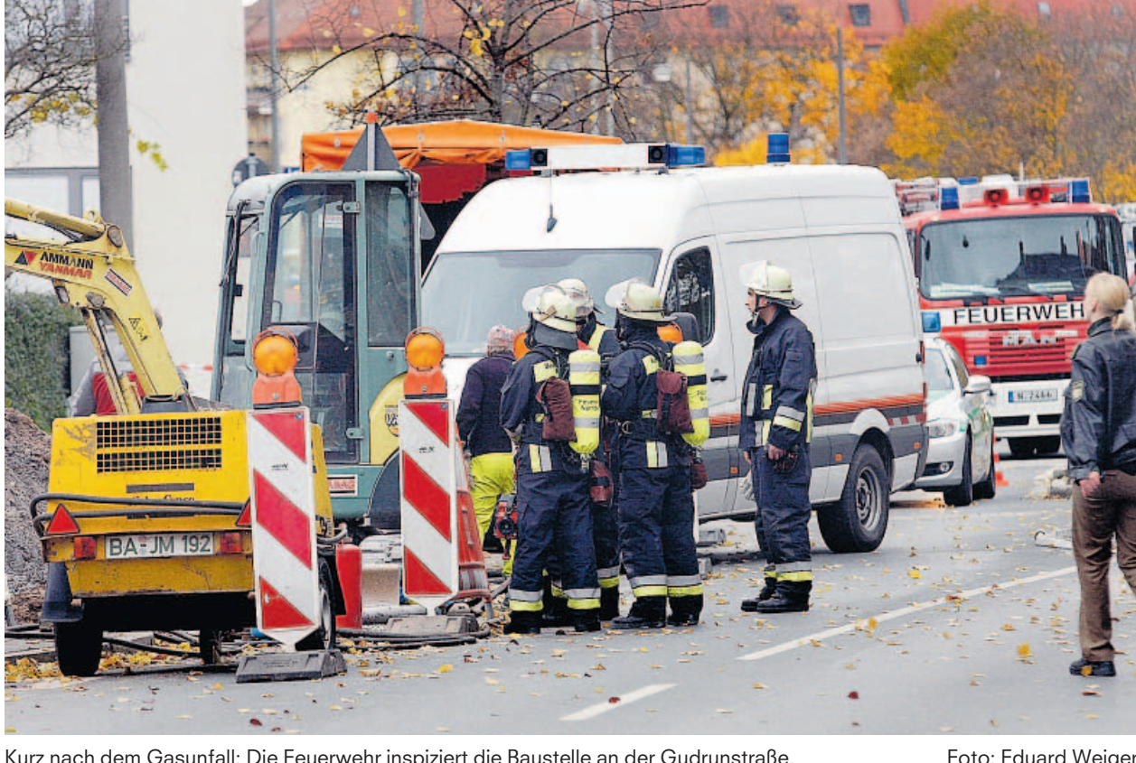
Kurz nach dem Gasunfall: Die Feuerwehr inspiziert die Baustelle an der Gudrunstraße.
