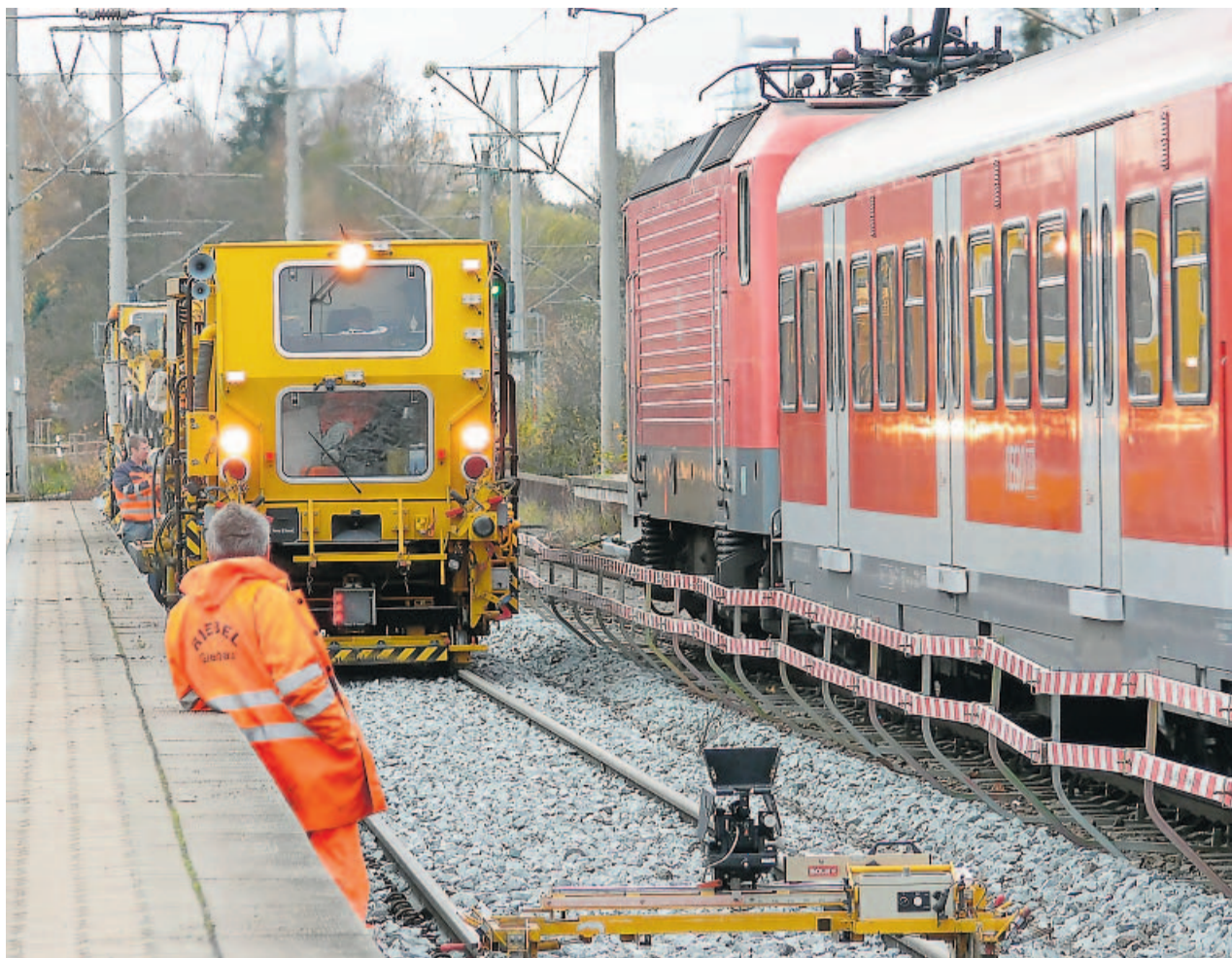
Bahnkunden sollen nicht kraxeln müssen: Weil die Einstiege der künftigen S-Bahn-Triebwagen 20 Zentimeter tiefer liegen als bei den bisherigen Zügen, werden an einigen Stationen — hier Lauf West — die Gleise höhergelegt. Foto: Thomas Kohl
